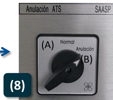
ANULACIÓN ATS (CUT-OFF)
