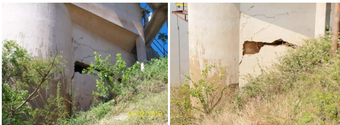
Figura 5.2 Vista de las fisuras y desprendimiento de la mampostería
