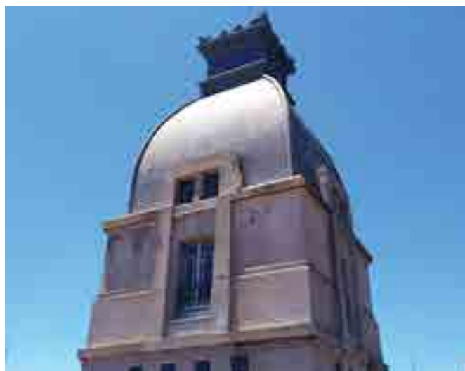
Fotografía actual. Se perdió el remate de la cúpula, el revestimiento de pizarra, el balcón con su herrería y fue "planchada" por completo, despojada de todo elemento ornamental que poseía.
